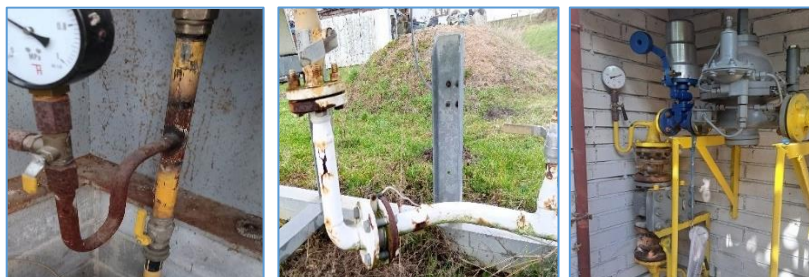
Obrázek č. 14a, 14b a 14c - Nedostatečná údržba a ochrana proti korozi
