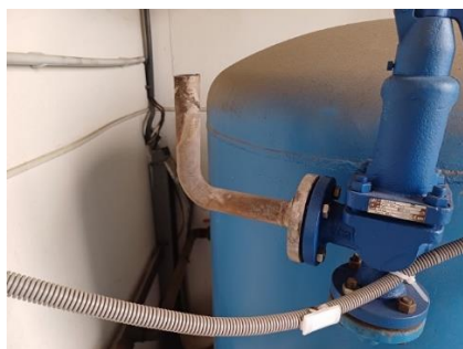
Obrázek č. 20 - Neukotvený odfuk pojistného ventilu TNS
