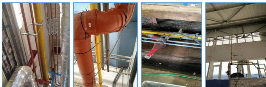
Obrázek č. 16a, 16b, 16c a 16d - Nedostatky spojené s plynovodem
